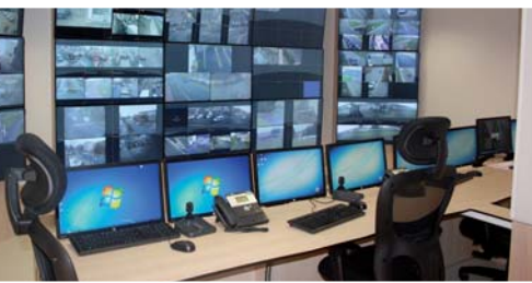
Le Centre de Supervision Intercommunal (CSI) sur les Hauts de Margny
