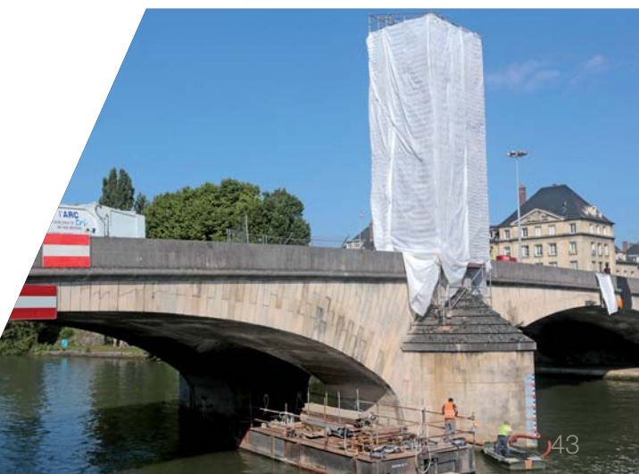
Le pont en pleins travaux : voirie, réfection des trottoirs, sablage et illumination
