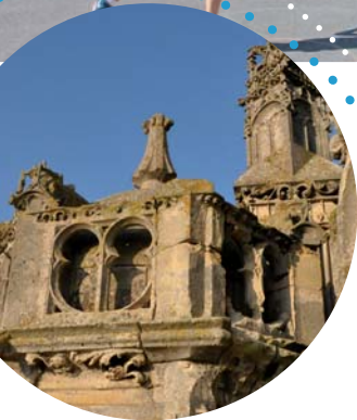
L'église Saint-Jacques doit subir de gros travaux
