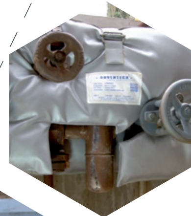
WEYLICHEM, isolation des tuyaux pour réduire les déperditions énergétiques
