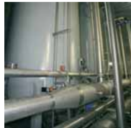
L'unité de traitement de l'eau potable des Hospices nouvellement installée.
