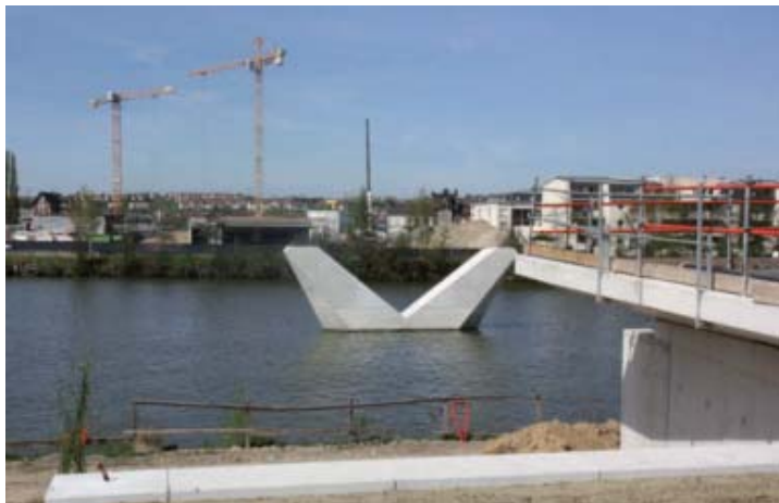
La pose des travées du nouveau pont se fera en deux temps : les 3 et 4 mai, puis les 10 et 11 mai.
