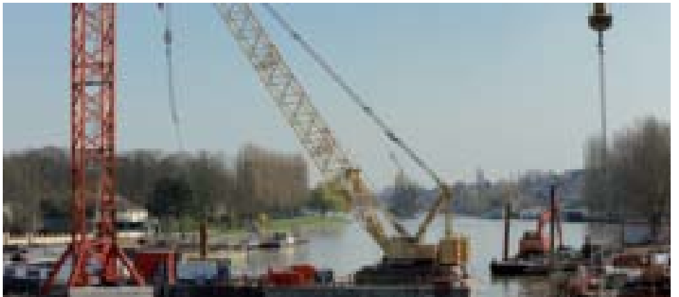
Prochaine étape spectaculaire pour le barrage de Venette : l'assemblage de la nouvelle passerelle prévue en octobre
