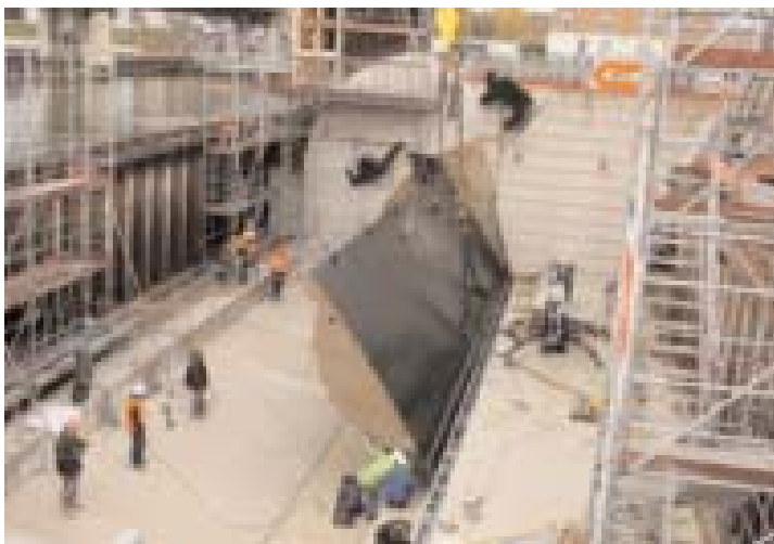
Un clapet de 52 tonnes a été posé sur le nouveau barrage de Venette.
